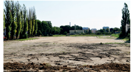
Podziemny zbiornik retencyjny przy ul. Olszewskiego
